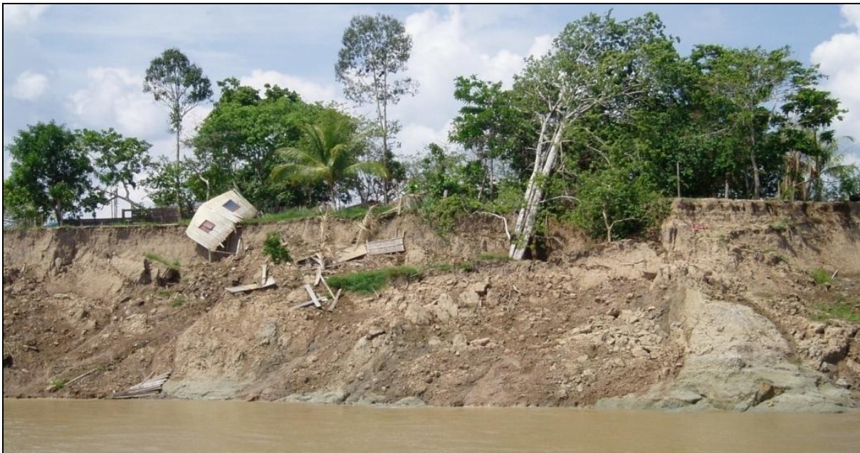
Figura 3. Zona de erosão na área 1, próximo ao município de Manacapuru, demonstrando o desmoronamento de casa pelo fenômeno de "Terras Caídas".
